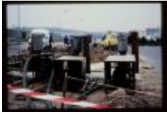
Regie Water (Dia container 19_2178)
